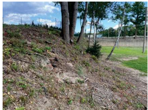
Foto 76: Böschung östlich Lutzweg
