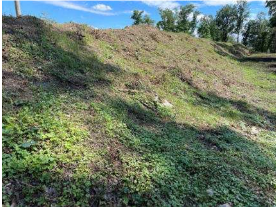
Foto 51: Erdhaufen westliche Böschung mit leichtem Bewuchs
